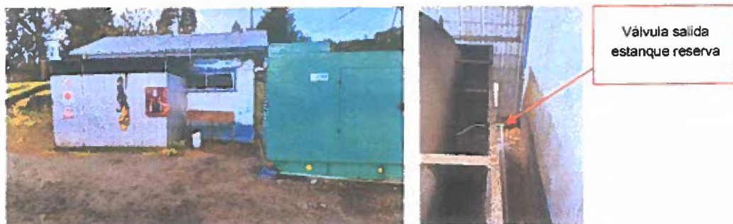
Estanque de Reserva y Grupo electrógeno (Izquierda) y válvula de salida estanque de reserva (Derecha)
